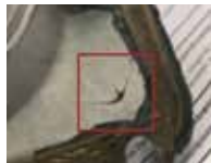
Unnötiger und übermäßiger Auftrag von Dichtmittel.
